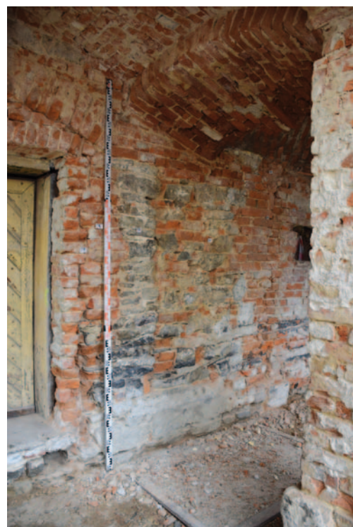
Původní vstupní otvor do kuchyni ze strany předhradí byl identifikován v severní obvodové zdi tzv. Müllerova domu. V rámci mladšího barokního zdiva je patrný jeho pozůstatek v podobě východní části ostění vyzděného z lomového kamene a torza prahu z tufitového kvádrů.
