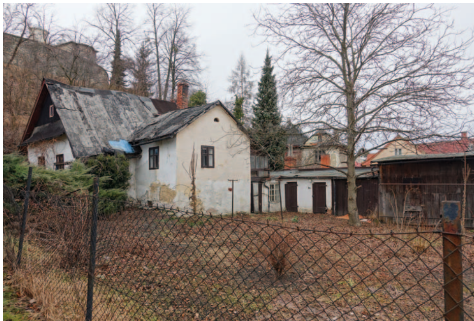
Pohled na dům čp. 383 od jihovýchodu těsně před demolicí. K východní zděné světnici zbudované nad sklepem ze severu přiléhala dřevěná veranda venkovního schodiště a přízemní provozně-hospodářská přístavba, zčásti zděná a zčásti bedněná (Foto P. Huvar, 2017)
